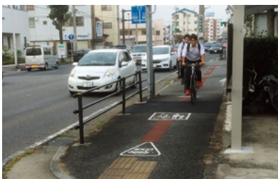
南部大橋線(南町四丁目)街路樹根盛り上がりを平らに整備(10月9日撮影)
